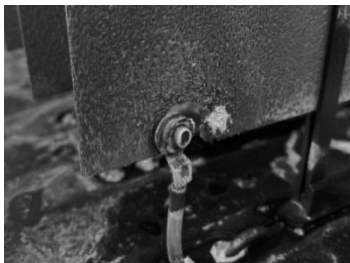
図 12 電線締結部での電極の切断
