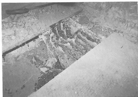
図5 蔵の床下の巣
